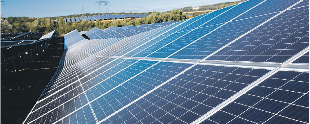
La ferme d'Engie Green, installée sur une ancienne friche à Marcoussis (Essonne), est la plus grande centrale solaire au nord de la Loire. ROMUALD MEIGNEUX/SIPA
